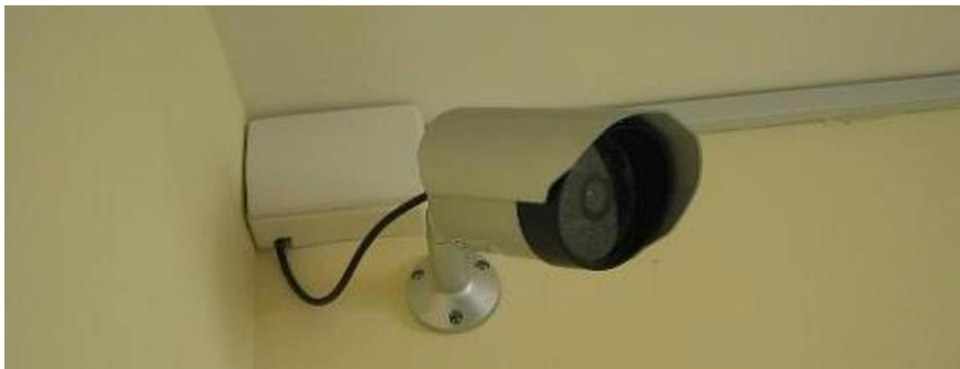
Figura 15 Cámara de seguridad
